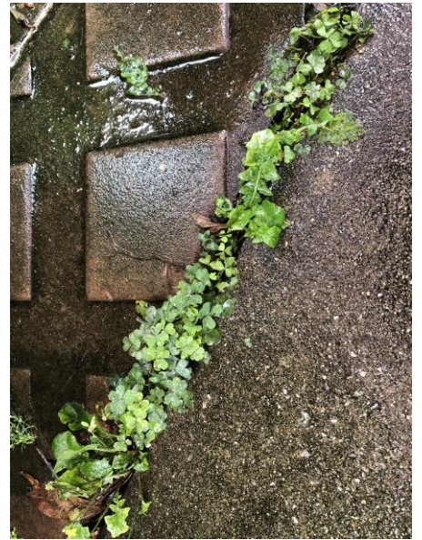
コンクリートの隙間に生えた小さな雑草もイキイキしていました
